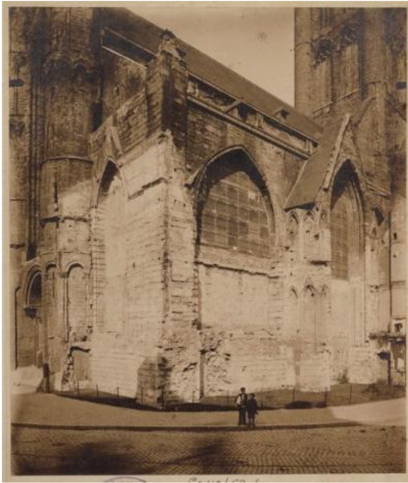
Afbeelding 31: datum onbekend, foto van de hoek tussen de westgevel en de zuidoostgevel, na verwijdering van het aangebouwde huis. 220
