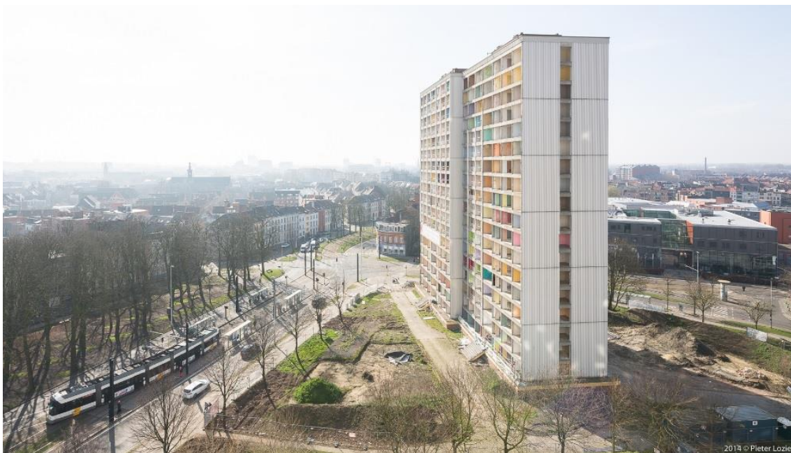
Figuur 75 Architect Jules Trenteseau, Rabottoren, 1972-1974, de eerste sociale woontoren aan het Rabet is reeds ontruimd en ontdaan van gevelpanelen 79
